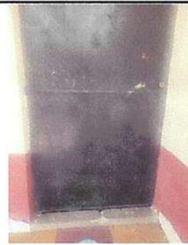
Foto 4: Se necesita sustituir puertas de 2 aulas
