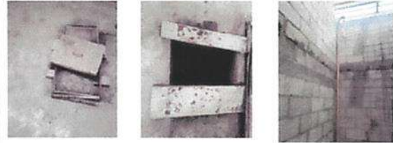
Foto 2: Se necesita mantenimiento para fosa séptica
