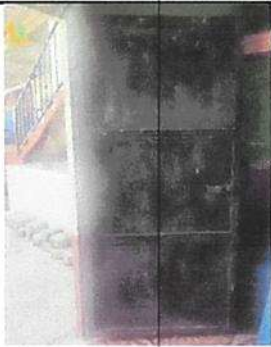
Foto 3: Se necesita sustituir puerta para cocina
